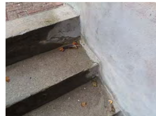
Kældertrappe med skader på trin
