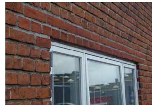
Eksempel på defekt murværk gedefacade
