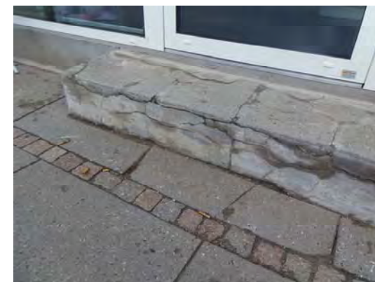
Eksempel på trappetrin med defekte overflader
