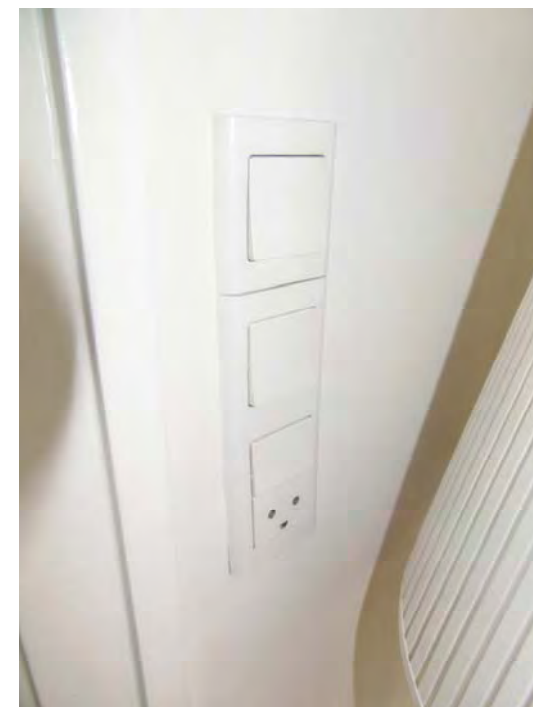
Eksempel på nye elkontakter i lejlighed
