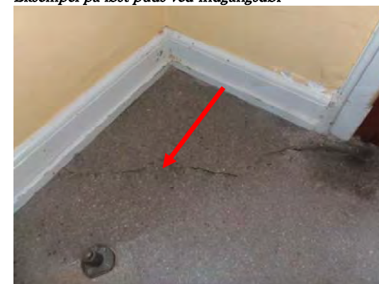
Eksempel på revne i terrazzo ved indgangsrepos.
