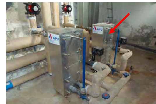
Nyere varmevekslere i teknikrum
