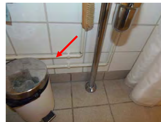
Eksempel på udskiftet, synlig rørføring badeværelse
