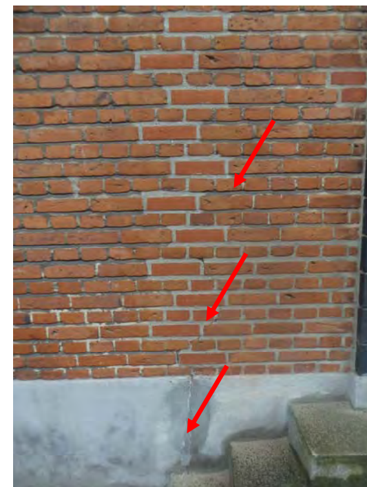
Lodret revnedannelse mod Regenburgs-gade
