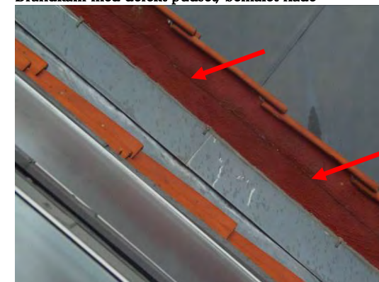
Brandkam med gennemgående revne
