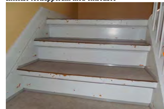
Eksempel på stødtrin og vanger med afskallet maling
