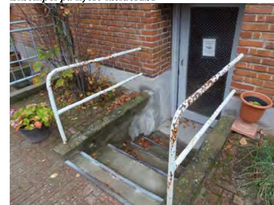
Eksempel gammel gitterdør mod opr. affaldsrum
