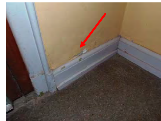
Eksempel på løst puds ved indgangsdør
