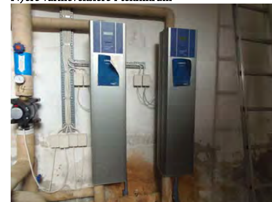
Katalyseanlæg i teknikrum
